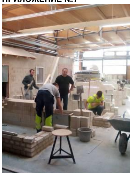
2015-1-BG01-КА102-014120 - „Усвояване на нови умения и подходи за обучители по нискоенергийно строителство” Секторна програма “ЕРАЗЪМ +”, мярка КА1 Категория на дейността „Образователна мобилност за обучаеми и учители в сферата на ПОО“
